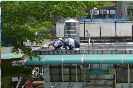
太陽能光電系統架設於警衛室上方。
