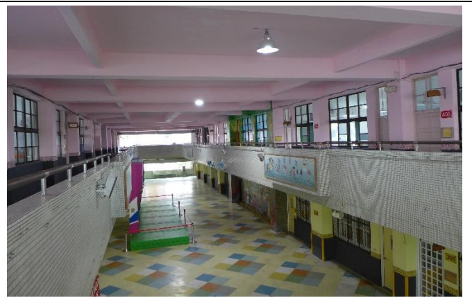
說明：走廊、樓板使用節能燈具。
