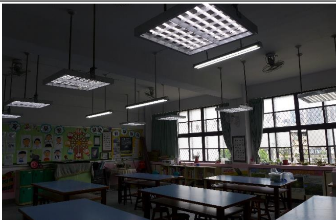
說明：教室內皆使用高效率省電燈具。
