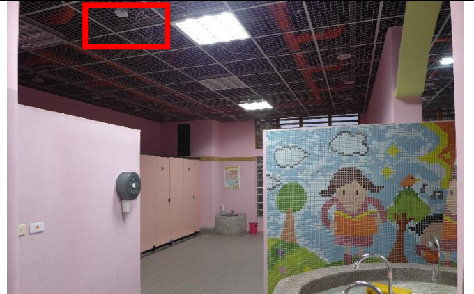
說明：新建廁所共 20 間，設置點滅裝置-燈控感應開關。
